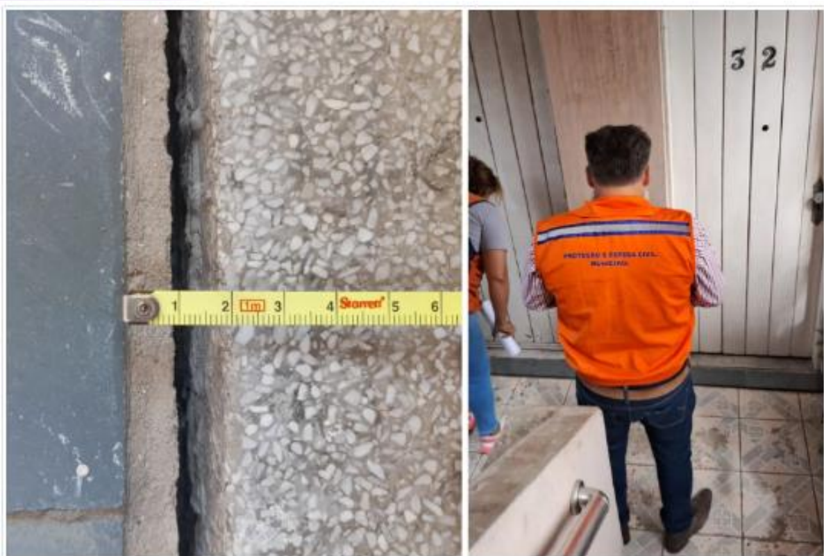
Fissuras após as obras chegaram a um centímetro e moradores estão preocupados no Conjunto Habitacional Wilson Sória. Foto: Arquivo pessoal
