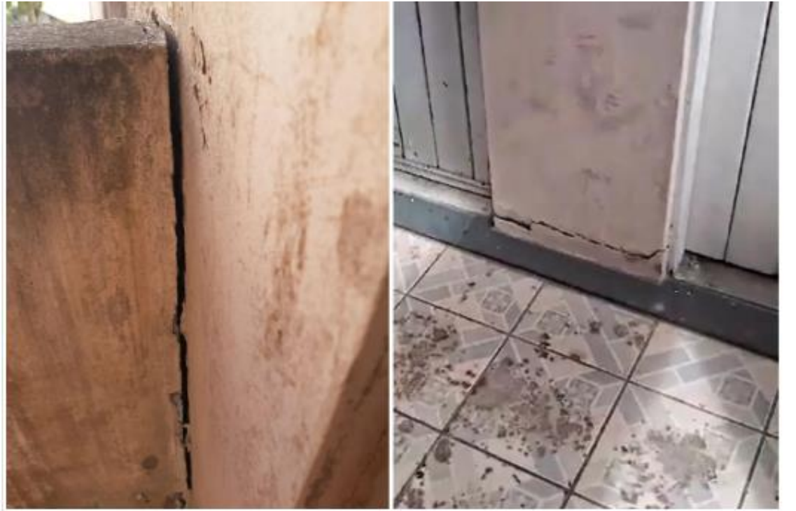
Fissuras podem ser vistas em escadaria e no batente de portas. Foto: Arquivo pessoal
