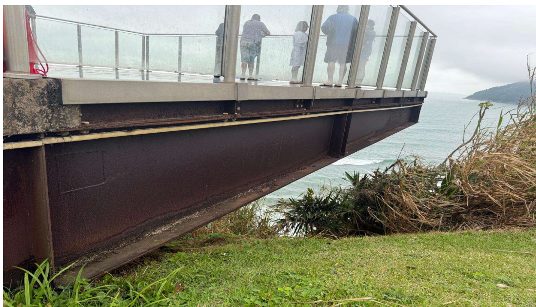
Imagem IV – Recuperação estrutural de viga metálica, a mesma encontrava-se com pontos de maresia e corrosão.
