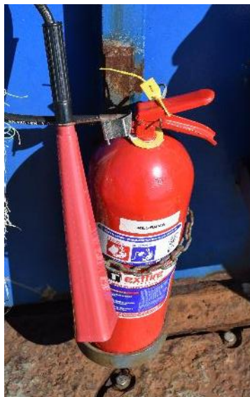
Figura 5: Um dos extintores presentes na balsa Marfort-9
